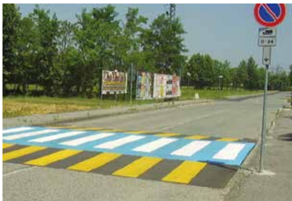
Attraversamento pedonale rialzato non conforme a legge
