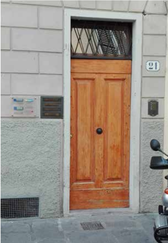
Portone d'ingresso che non consentiva l'installazione sopra lo stesso di cassette postali risolto con l'installazione di box d'acciaio inox con cassette di posta in orizzontale
